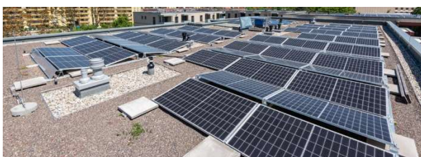
Foto PV Dach
