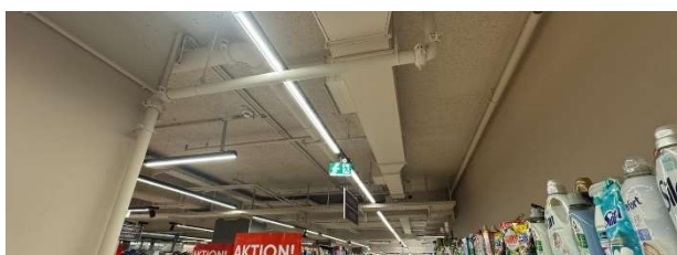
Foto einer Decke mit einer Vielzahl an technischen Anlagen
