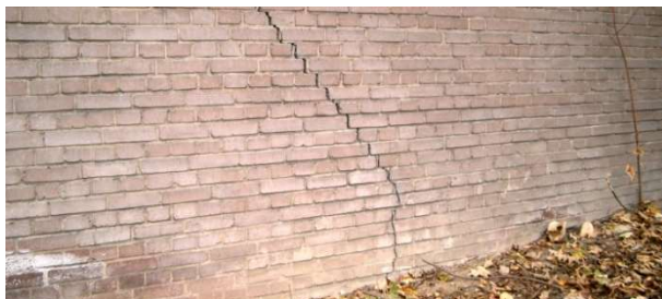
Setzungsriss (Quelle Erkapfahl)
