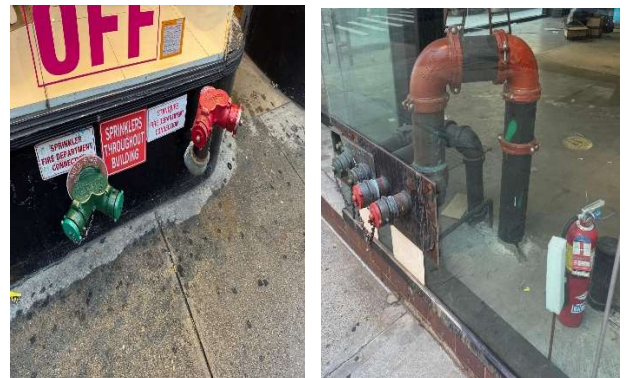
NY Feuerweherschläüsse für trockene Steigleitung und Sprinkleranlage
